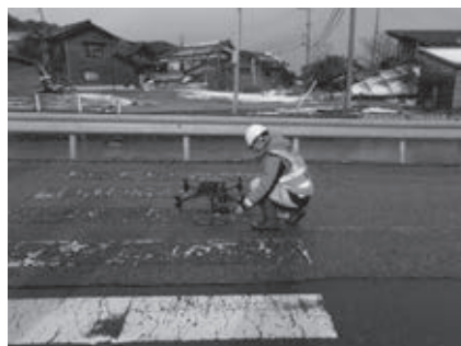
写真4：UAV飛行前の機体確認状況
